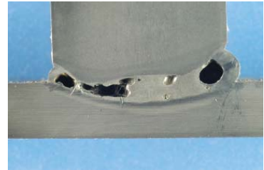
Kopfbolzenschweißen mit zahlreichen Poren, verursacht durch zu geringen Schweißstrom (falsche Geräteeinstellung).
