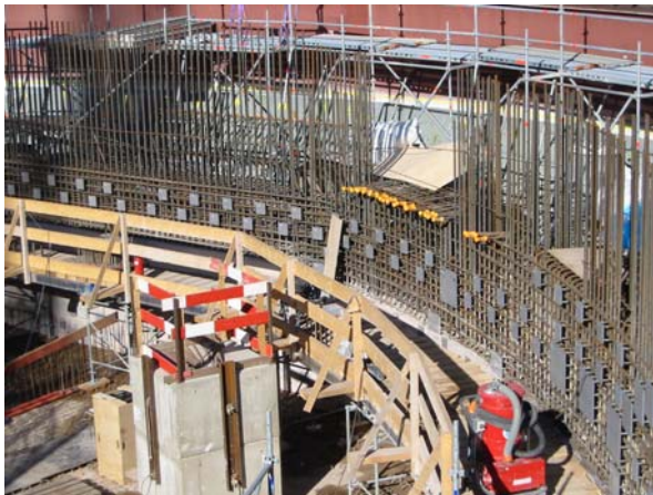
Bild 15: Ankerplatten in einem Kernkraftwerk
